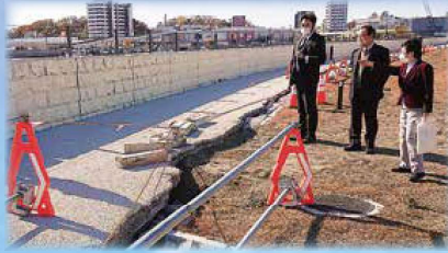
破損した北浜防潮堤の調査(2020年11月)
